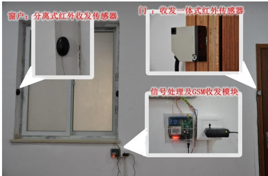
项目组安装在教师办公室的实际样机
